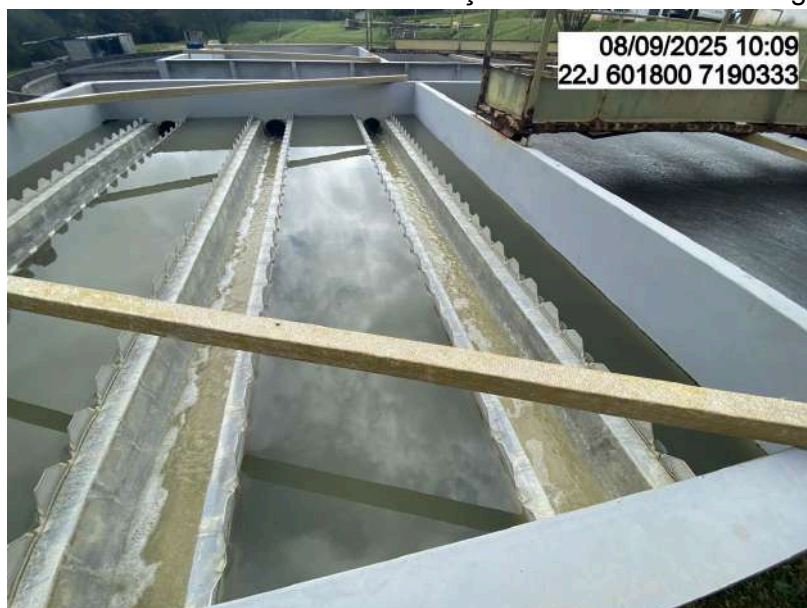
Figura 34: Decantador secundário da Estação de Tratamento de Esgoto.
