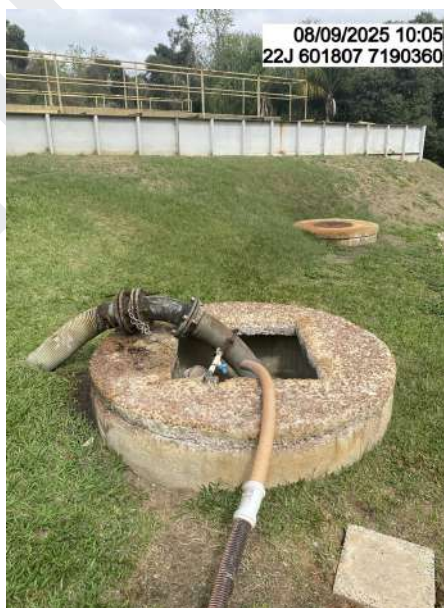
Figura 41: Ponto de amostragem de efluente tratado da Estação de Tratamento de Esgoto.
