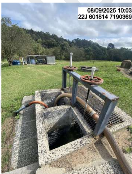
Figura 43: Saída de efluente tratado da Estação de Tratamento de Esgoto.
