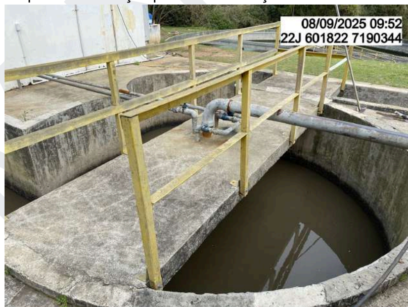
Figura 35: Tanque de decantação primária da Estação de Tratamento de Esgoto.
