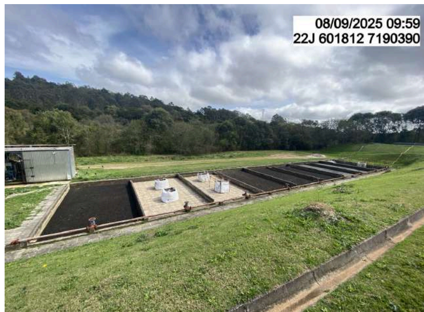
Figura 46: Leitões de secagem de lodo da Estação de Tratamento de Esgoto.
