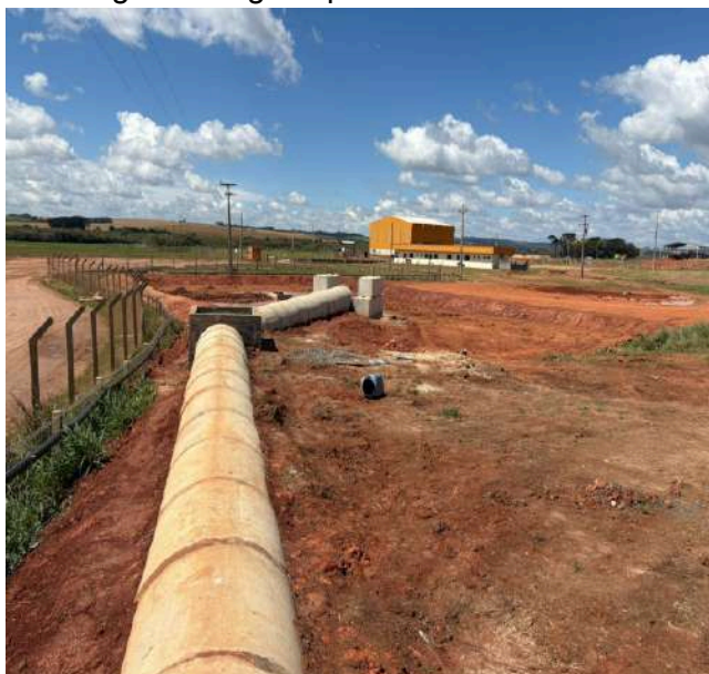
Figura 59: Sistema de drenagem de águas pluviais do aterro sanitário de Ponta Grossa/PR.
