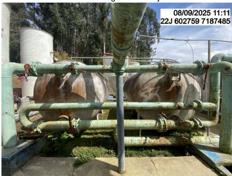
Figura 22: Filtros de tratamento de água da Estação de Tratamento de Água.
