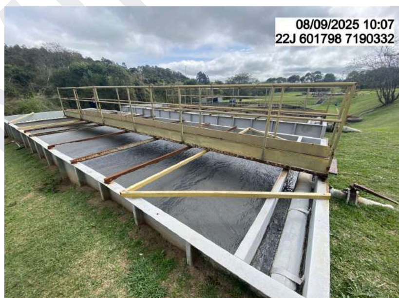
Figura 37: Vista dos tanques de aeração da Estação de Tratamento de Esgoto para o tratamento biológico.
