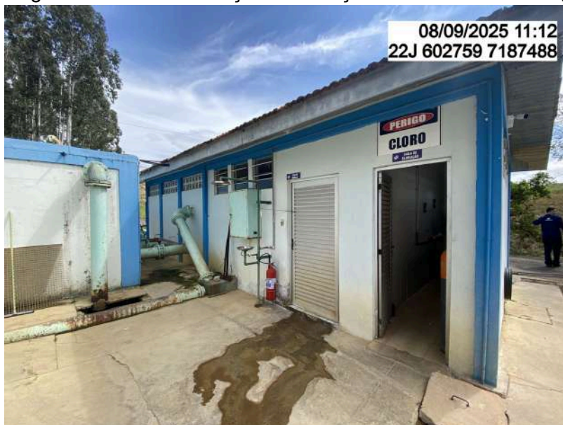
Figura 20: Sala de cloração da Estação de Tratamento de Água.
