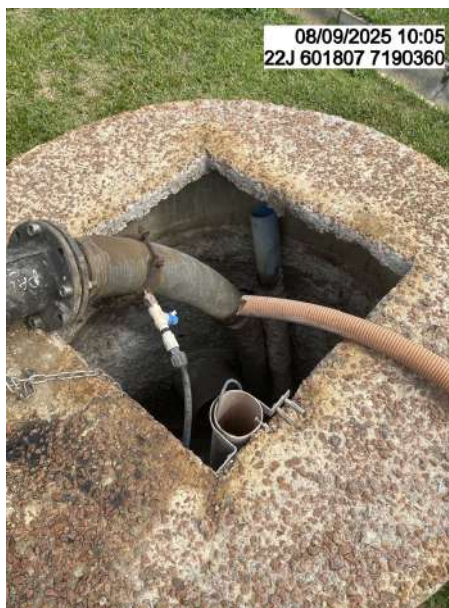
Figura 42: Ponto de inspeção da rede de esgoto da Estação de Tratamento de Esgoto.
