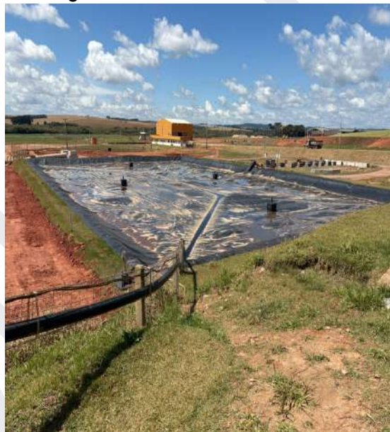
Figura 58: Sistema de drenagem de chorume do aterro sanitário de Ponta Grossa/PR.
