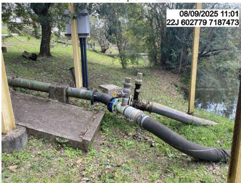
Figura 21: Captação de água bruta - conjunto de sucção com mangotes e tubulação de recalque.
