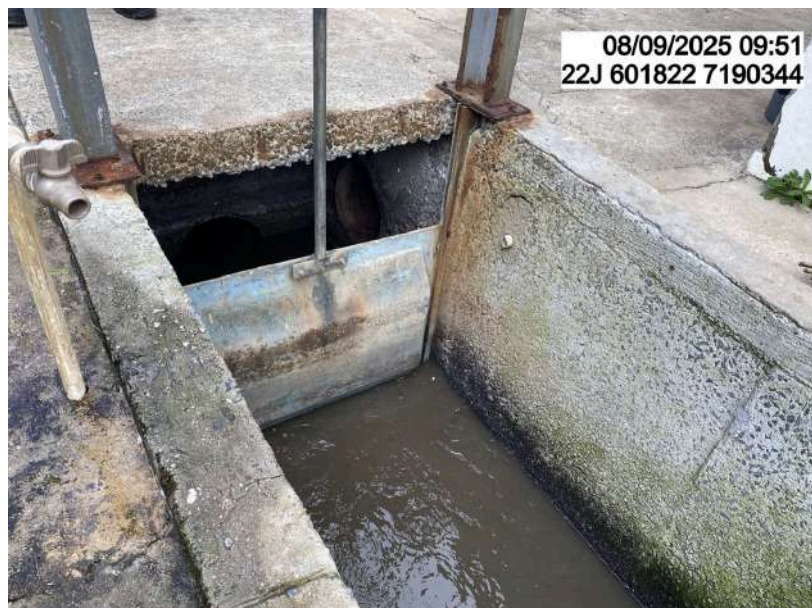
Figura 40: Detalhe da comporta de entrada do esgoto bruto da Estação de Tratamento de Esgoto.
