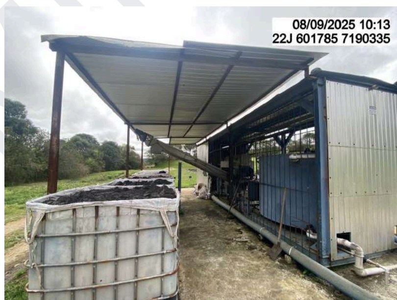
Figura 49: Sistema de desidratação de lodo da Estação de Tratamento de Esgoto, mostrando a fase de secagem e embalagem.
