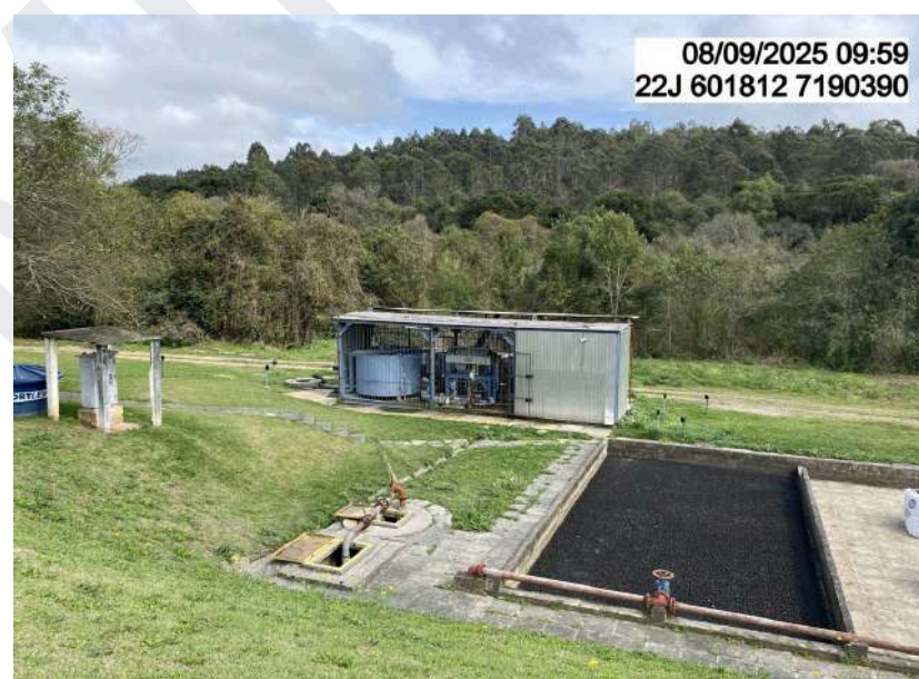
Figura 47: Vista geral da Estação de Tratamento de Esgoto, incluindo os leitos de secagem de lodo.
