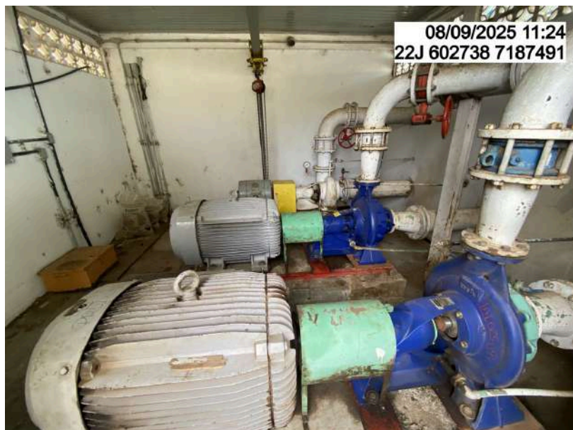
Figura 48: Casa de Bombas da Estação de Tratamento de Esgoto.
