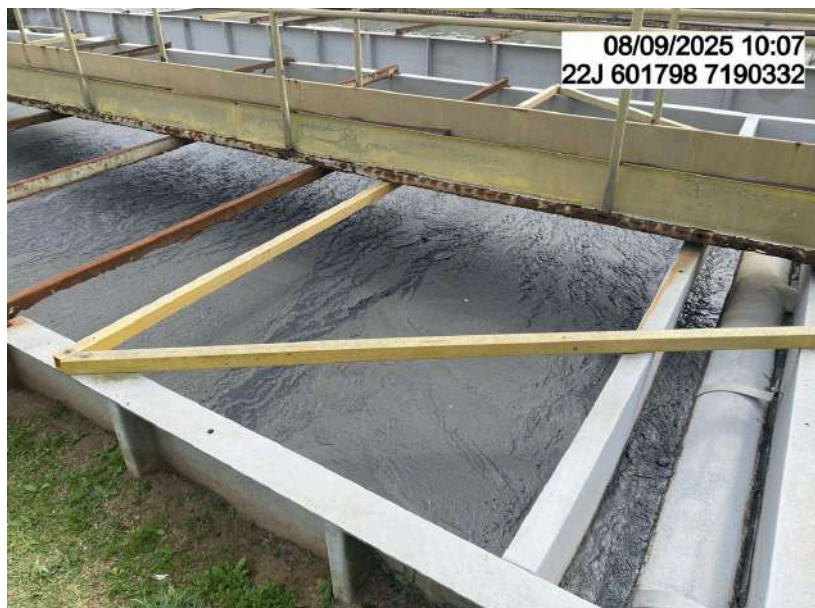
Figura 38: Vista em detalhe do tanque de aeração da Estação de Tratamento de Esgoto.
