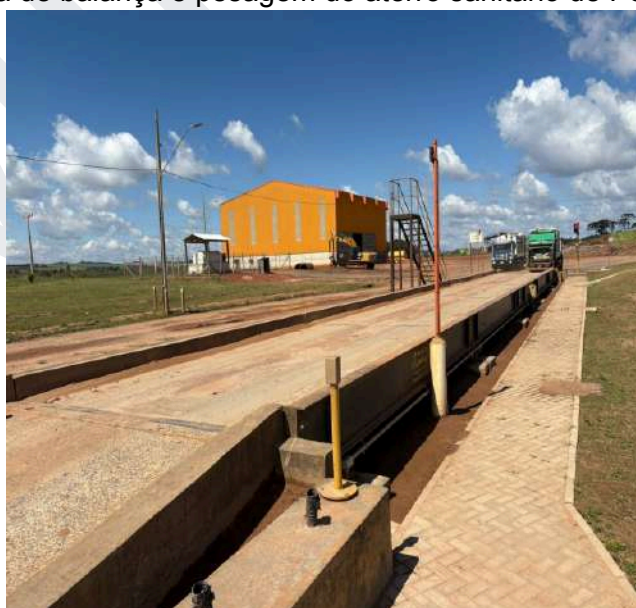
Figura 54: Estrutura de balança e pesagem do aterro sanitário de Ponta Grossa/PR.
